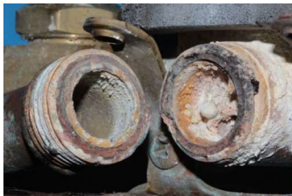
Exemplo de dezincificação
