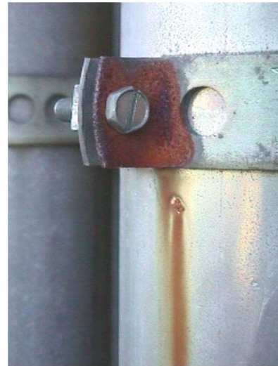
Exemplo de corrosão generalizada
